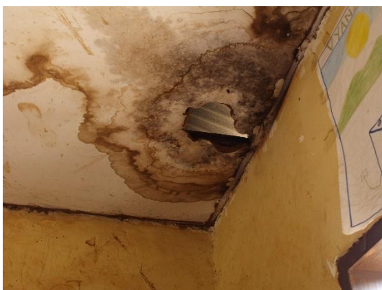
Die Feuchtigkeit durchdringt die Decke
